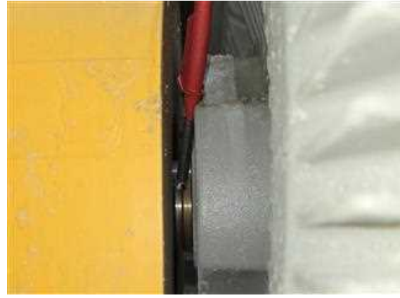
Figur 15: Spänningsprob med borste mot motoraxel på en växellåda.
