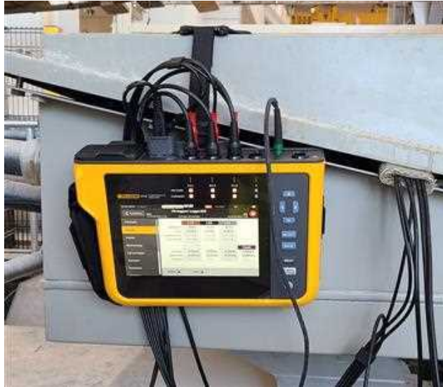
Figur 18: Fluke 1775 på maskinen efter filtret. I denna figur har inte maskinen blivit driftsatt än och lamporna lyser gult.
