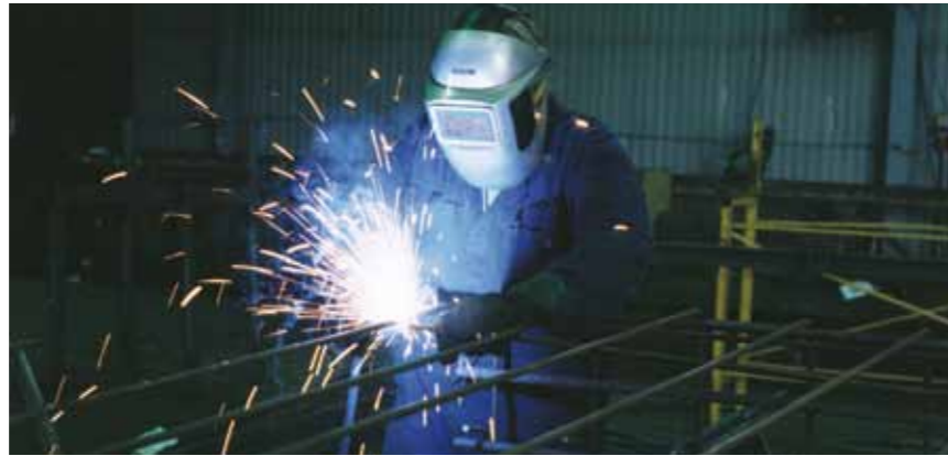
Svetsning av armering kräver behörig personal, måttnoggrannhet och formstabilitet. Vi har de personella och maskinella resurser som krävs för all slags svetsning av armering.
