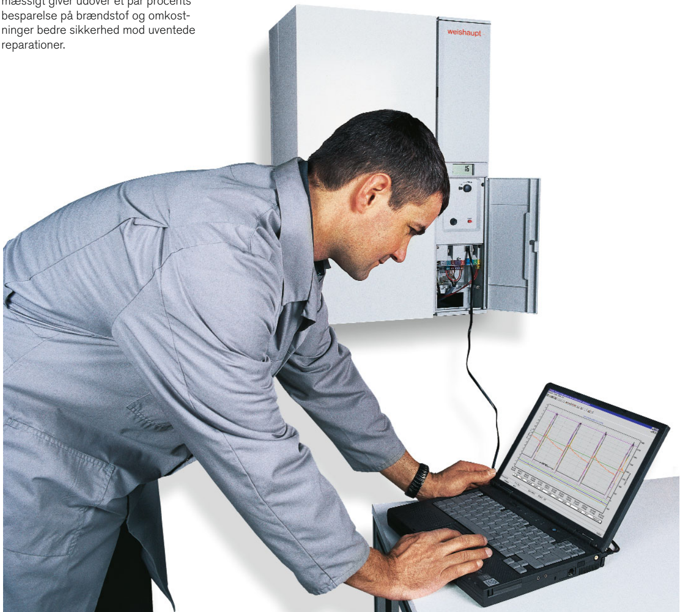
VVS-installatøren/serviceteknikeren kan aflæse og analysere samtlige driftsdata
