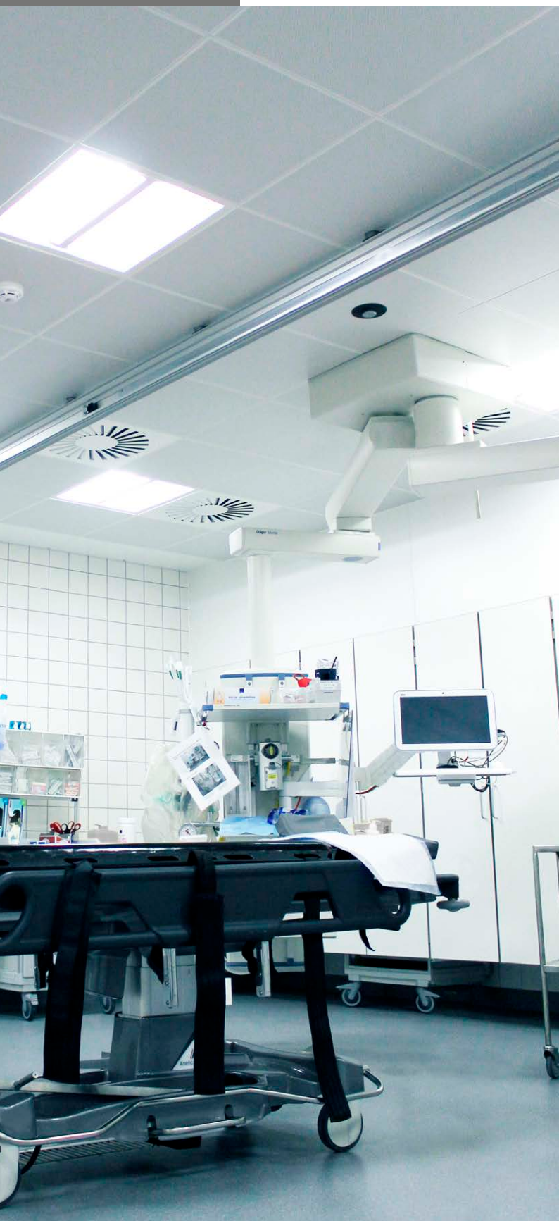
DAMPAs metallofter lever op til de høje rengøringskrav og kan bl.a. bruges på operationsstuer, som her på Aabenraa Sygehus.
