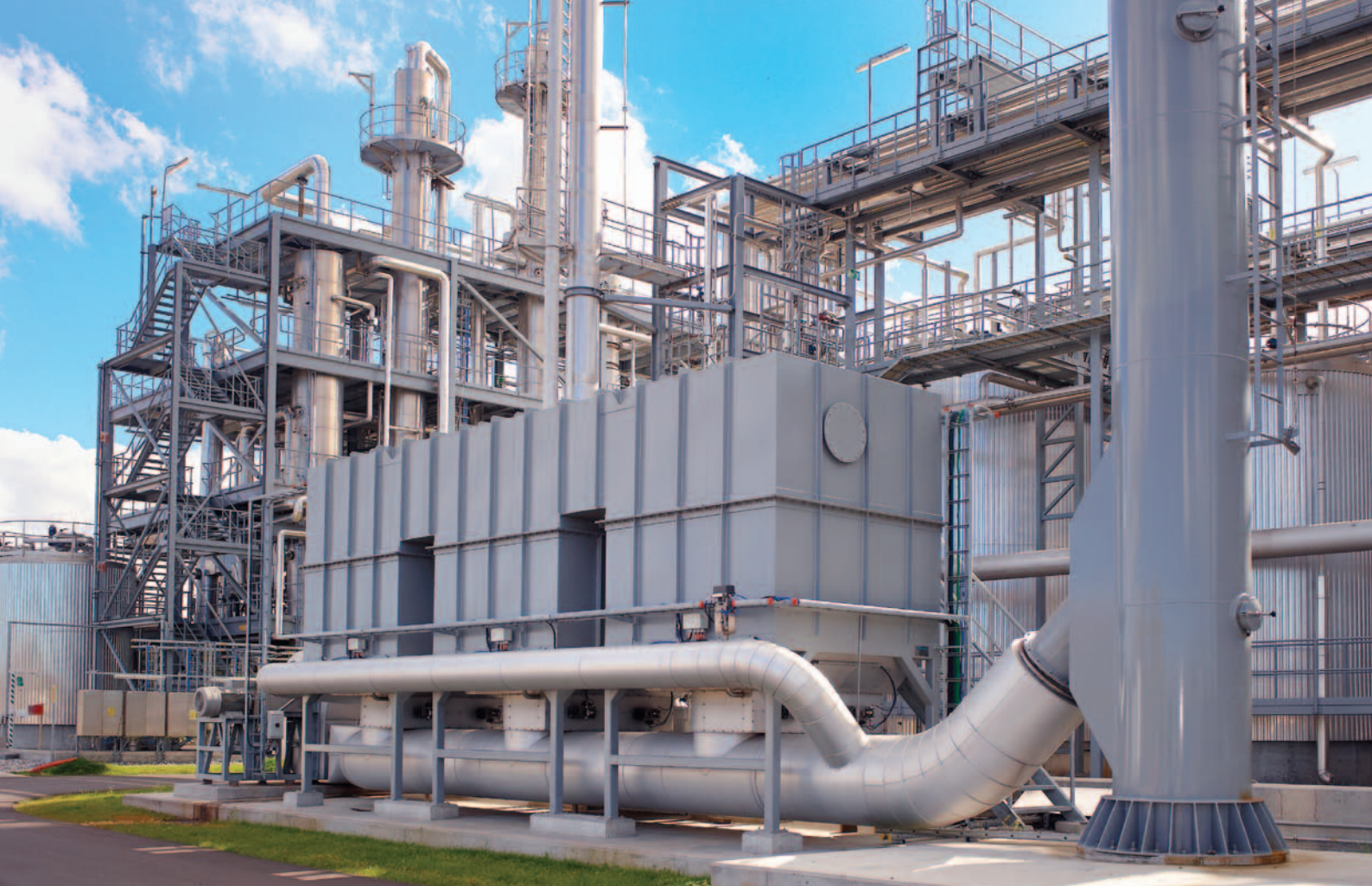
Demonstrationsanlægget i Kalundborg
