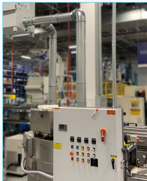
QFS Ducting installeret i bildelar fabrik
