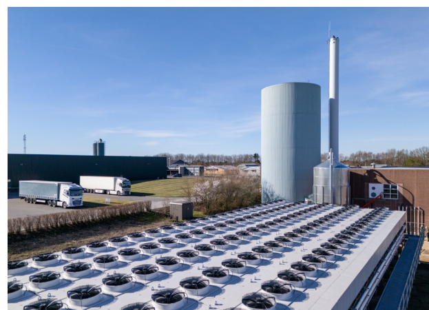
Energioptagere og ekstra energilager. Ved normal drift anvendes skorstenen ikke længere - synlig røg ses kun, når reservegaskedlerne er i drift.
