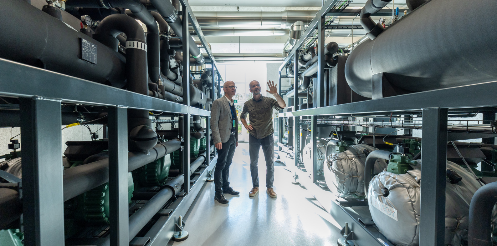
Gram Fjernvarmes to H-1800 varmepumper. Den ene kan skifte mellem luft og vand som varmekilde.
