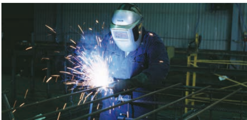
Svetsning av armering kräver behörig personal, måttnoggrannhet och formstabilitet. Vi har de personella och maskinella resurser som krävs för all slags svetsning av armering.
