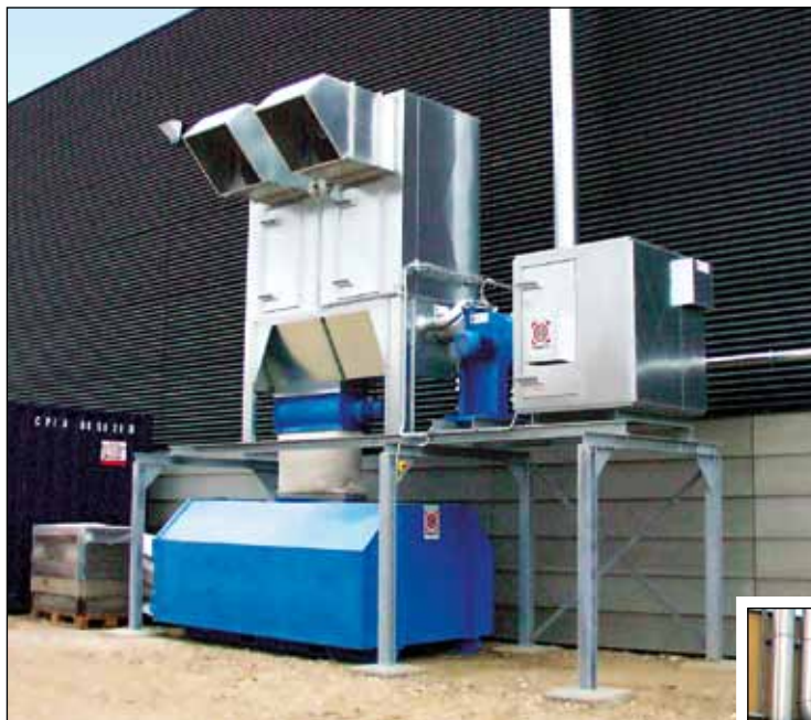
Lille slusefilter på containerstativ med en mellemtryksventilator samt et stk. højtryksventilator i lydboks.
