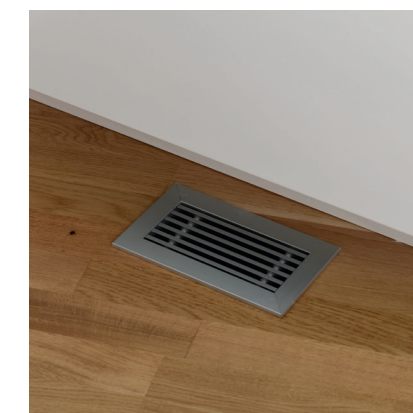
Indblæsningsrist monteret i gulvet.
