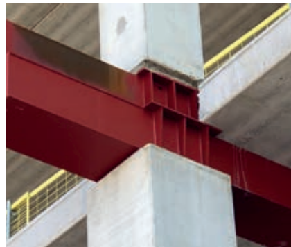
Bild 2. Vid stora laster och grova pelare kan man ibland bli tvungen att lägga till förstärkningar på utsidan liven.
