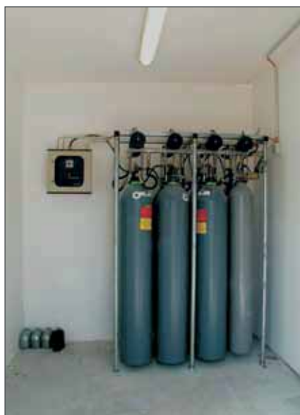
Slukningsmidler opbevares sikkert i teknikrum med F90-brandsikring
