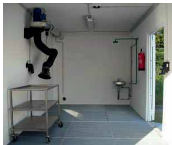
Individuel indvendig indretning med punktudsug, langt lysstofrør, håndvask og nødbruiser
