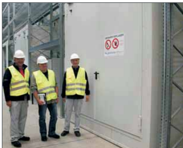
BCK R 2730-2-320 brandsikret reollager indbygget i et lager med høje reoler
