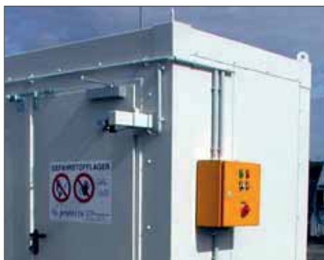
Elskab med branddørlukning med regulator til lukkerækkefølge
