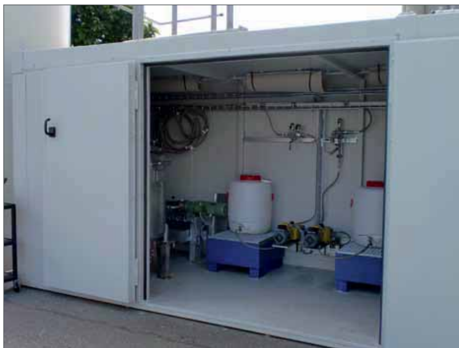
Udendørs teknikrum med ind- og udvendig F90-brandsikring
