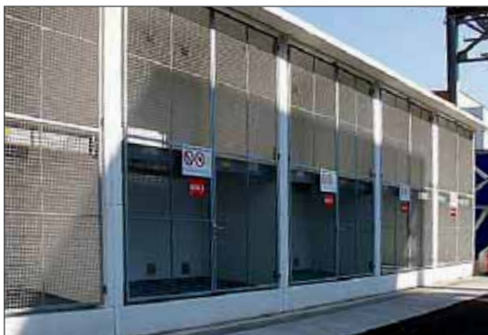
DK 06 reolcontaineranlæg med mekaniske gitterlåger.
