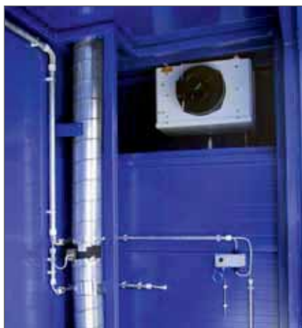
Reolcontainer med klimaanlæg, temperaturføler, teknisk udluftning og returluftudløb gennem taget
