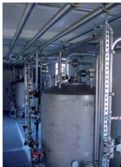
Teknikrum med indbygget blande- og doseringsanlæg
