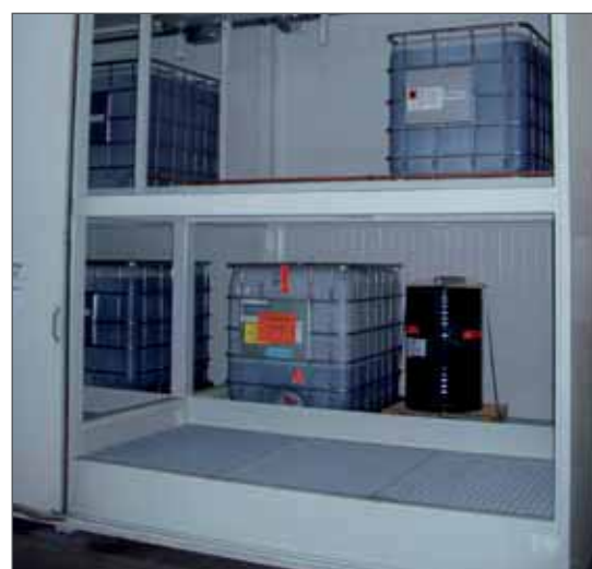
Sikring med pallestop
