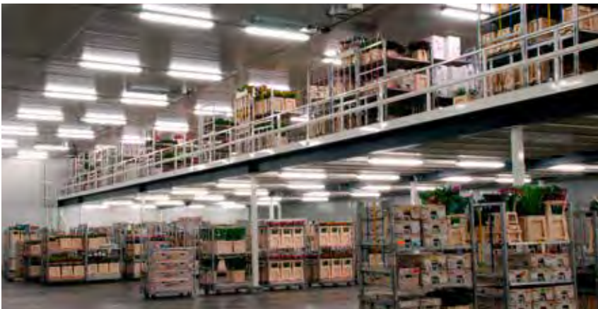
ME350 kan benyttes i alle sammenhenger der det foreligger behov for utvidet kontor- eller lagerplasser. Her en to etasjers mesanin hos en blomstergrossist. Gulvarealet er igjen tilgjengelig.
