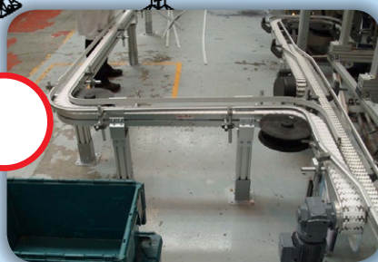
Sammenkøring af to conveyorer.
