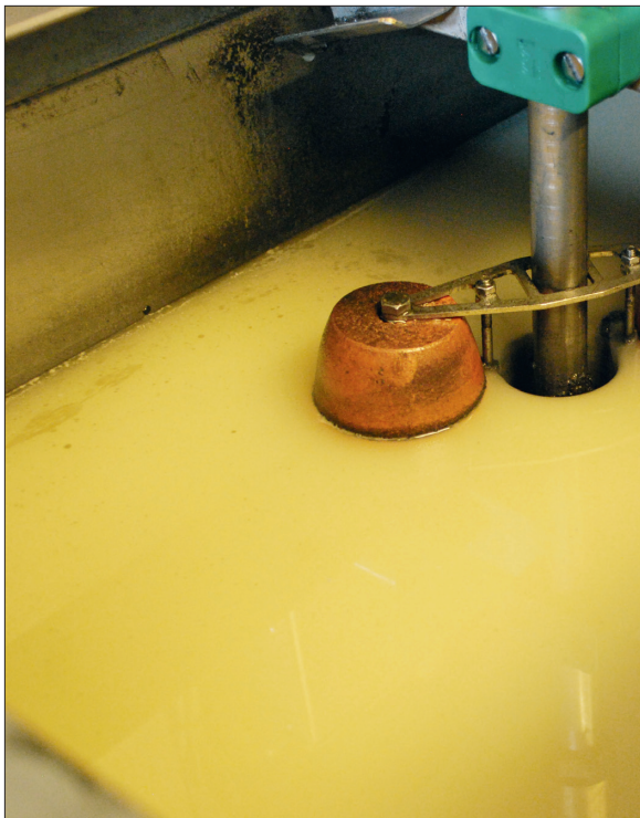
Efter filtrering ledes væsken videre gennem centralrenseanlægget via en labyrintlignende opbygning i tanken. Gennem labyrinten udskilles vange- og lækolier. På billedet ses sugehovedet til olieseparatoren.
