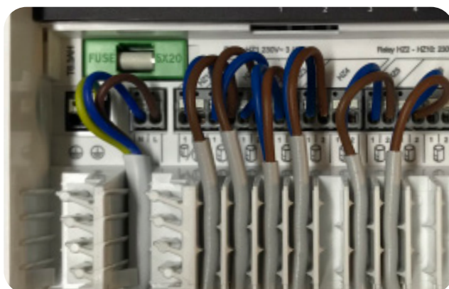
- telestaterne er ledningsført til styreboksen
