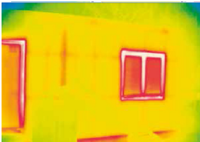
EFTER: Kuldebroen i elementsamlingen er forsvundet og omkring vinduet er de kraftigt reduceret.
