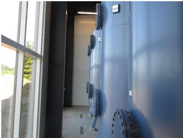
SILHORKO trykfiltre, 4 x TFB25 med svøbhøjde 2600 mm, opstillet i to parallelle linjer med for- og efterfilter. Ydelse 10-25 m 3 /h.
