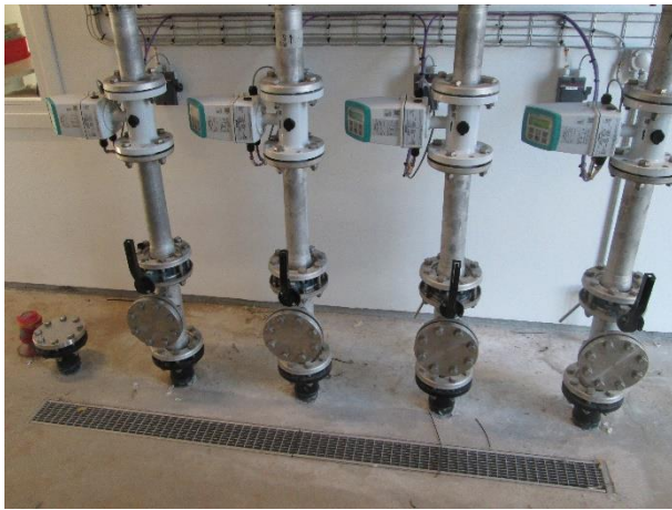
Råvandet bliver leveret af fire boringer.
