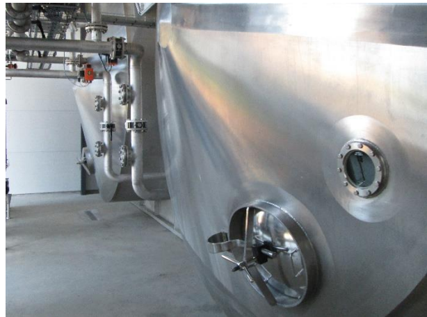
Vandrette rentvandstanke i syrefast rustfrit stål, 2 x 150 m 3 .
