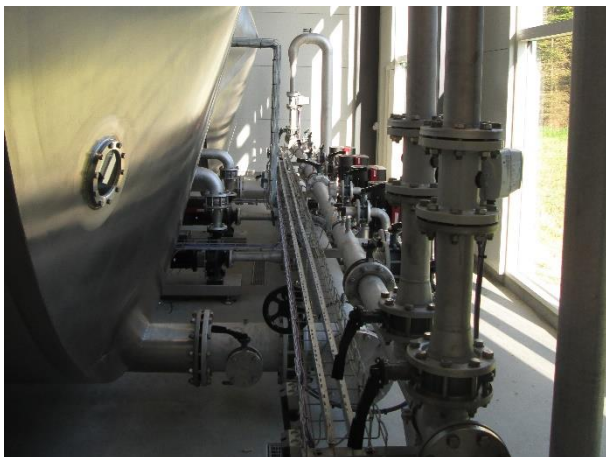
Udpumpningsanlæg. Forberedt for UV desinfektionsanlæg.
