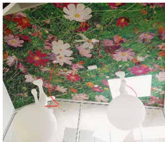
Blomstermotivet herover er Troldektek dekoration i Børnekulturhus Ama'r tegnet af Nøhr & Sigsgaard Arkitekter & Dorte Mandrup Arkitekter
