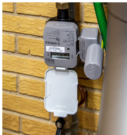
Vandmåler af typen E-series og en ORION-sendeenhed fra Badger Meter Inc. installeret på Rødekro Vandværk
