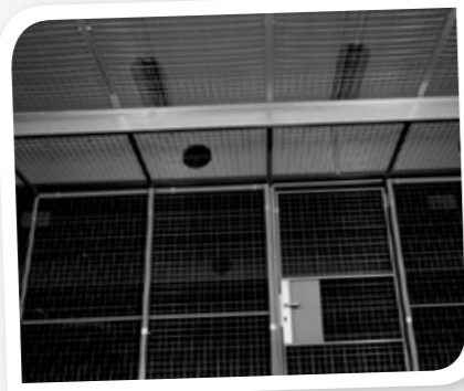
Tag Vores smarte nettagsløsning gør, at eksempelvis lys og vand fra et sprinklersystem let kan trænge igennem, og den giver også et godt overblik. Den kraftige bjælke giver en robust og sikker lofts-konstruktion.
