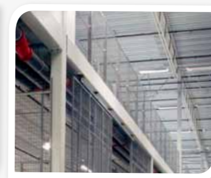
Mezzaniner Opdeling med netsektioner på en mezzanin beskytter både materialer og mennesker mod nedstyrtning af genstande.
