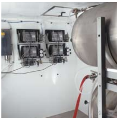
Kompressorer installeret i forbindelse med fadølsanlæg
