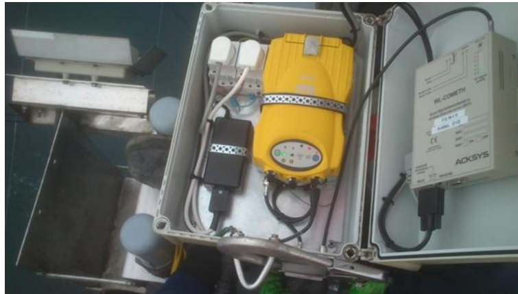
Figur 3: Tidligere receiver monteret i boks med strømforsyning.
