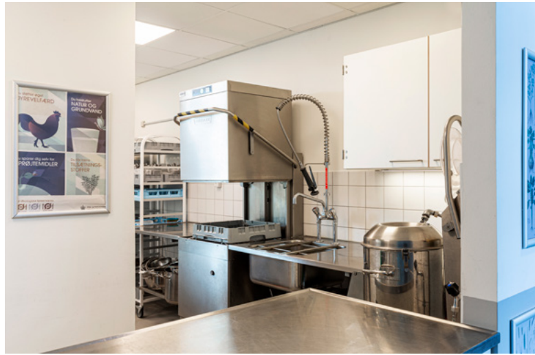
OPVASKEAFDELING med hætteopvasker, forbruser og indstiksvogne til opvaskebakke opbevaring
