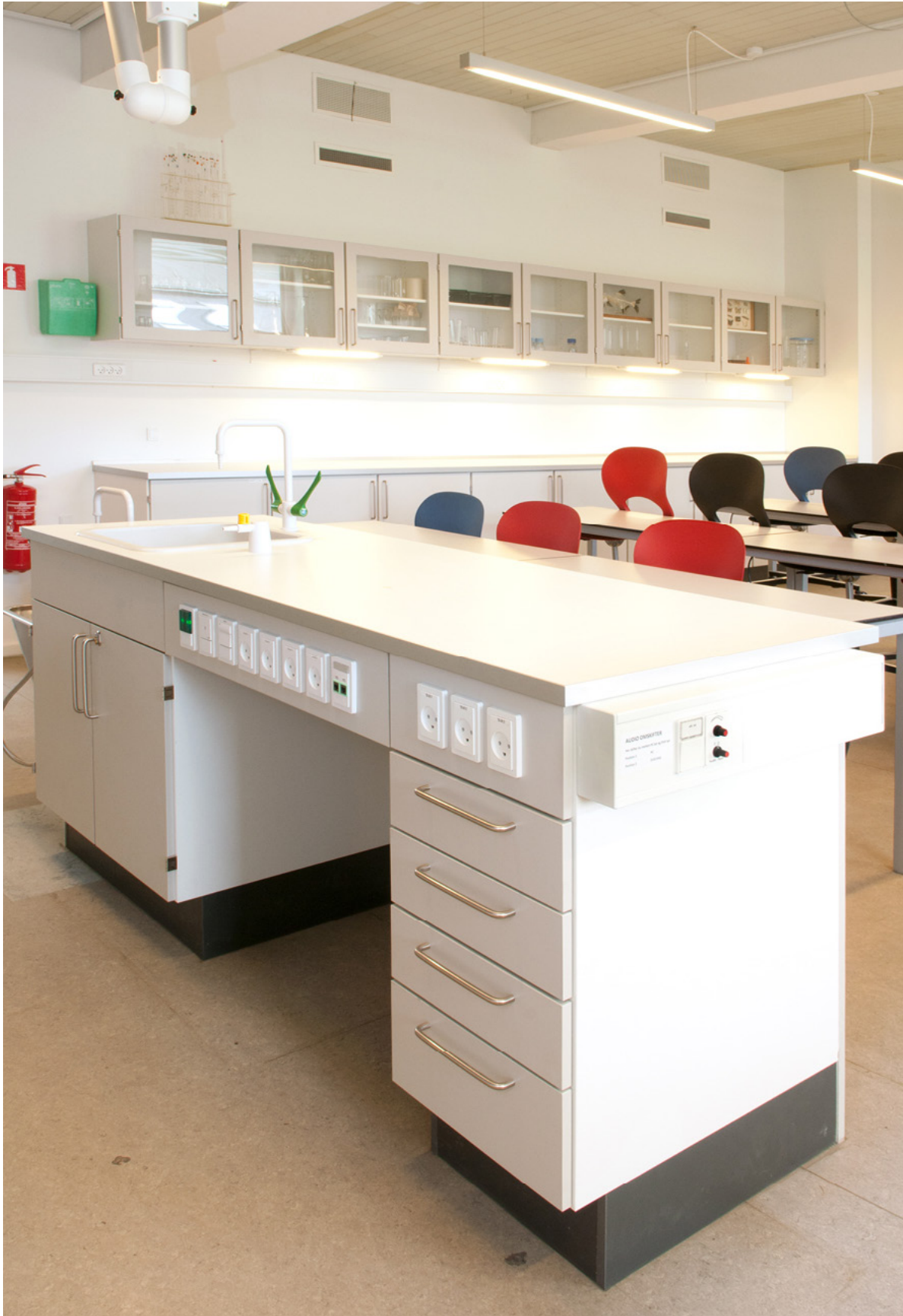
LÆREBORD med alle de nødvendige installationer som el og gas, samt laboratorie vask og armaturer
