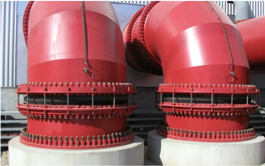
Store kompensatorer med længdebegrænsere på kraftværk
