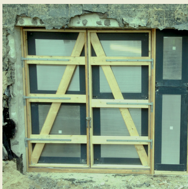
Porte Nem adgang med materiale
