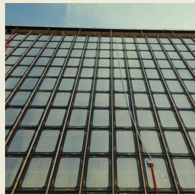
Midlertidig aflukning Facader eller stilladser
