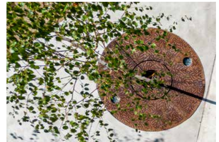
Træhulsristene er monteret med Uplight / spotlys fra Iquzzini.
