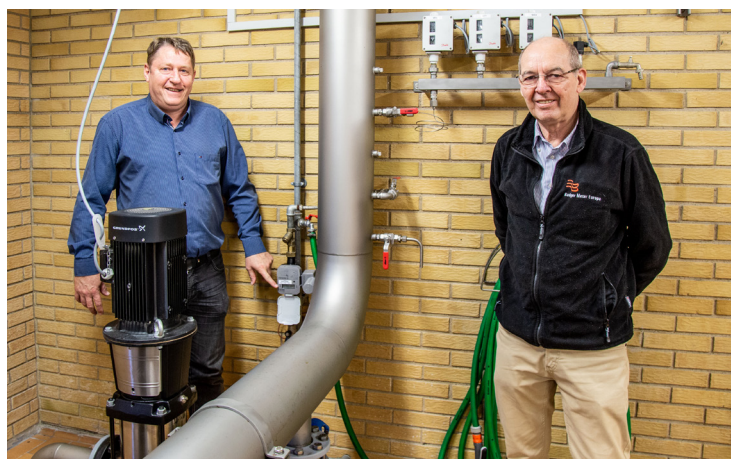
Vandværksbestyrer Steen S. Holm, Røde Kro Vandværk, t.v., og produktchef Danilo C. Chiappini, V. Løwener A/S, t.h., viser vandmåler af typen E-series og en ORION-sendeenhed fra Badger Meter Inc. installeret på Røde Kro Vandværk.
