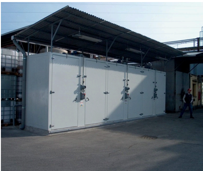
Horisontal varmeovn til 48 tromler, opdelt i 3 individuelle rum, hver til 16 tromler. Temperatur op til 150°C, drevet af varm olie. ATEX godkendt og uden dørs installeret.
