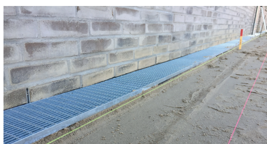
Sokkelrenden monteret og grus afrettet så det er klar til udlægning af fliser. Risten møder belægningen uden ekstra kant.
