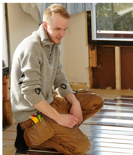
Dennis Granhøj besigtiger gulvet med varmfordelingsplader, inden han påbegynder montering af overgulv.
