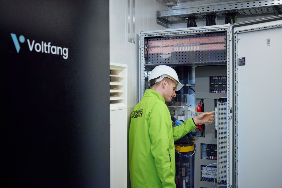
Voltfang batterilagringssystem hos Phoenix Contact
