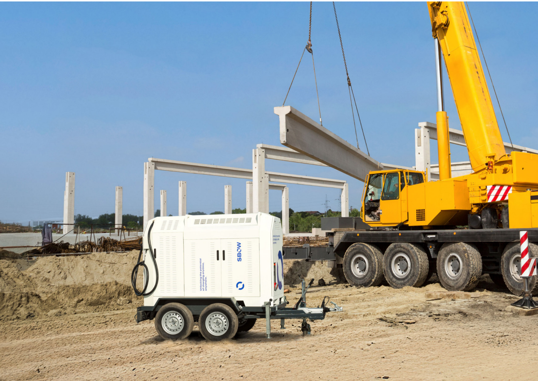
Den selvstændige elnetfunktion gør det muligt for dig at etablere dit eget AC-elnet
