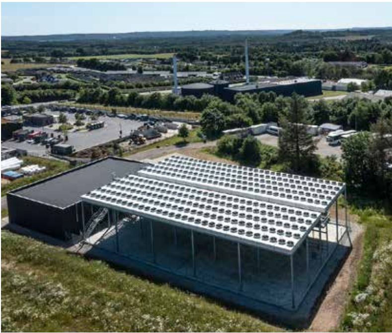
Ny nærliggende lokation med energioptagere og varmepumper
