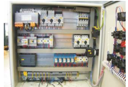
SPS Steuerung / PLC Control
