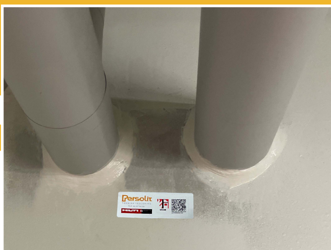
Brandlukning af rørgennemføring i gulv og væg.
