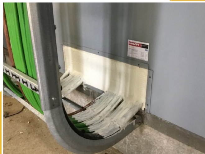
Brandlukning af kabelgennemføring i væg.
