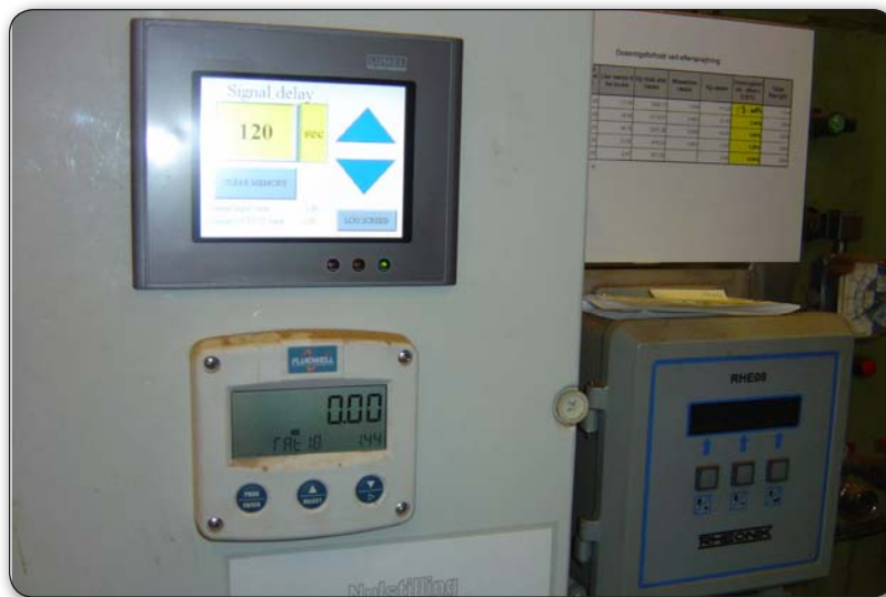
Styreskab med time-delay og F124 controller
