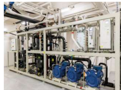
"COOL Booster+". CO 2 airconditionanlæg er her installeret ombord på en færge.
