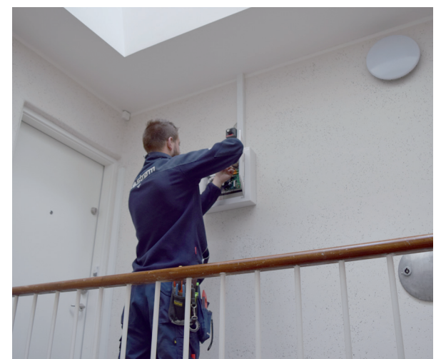
El-Strøm har stået for den indvendige el-entreprise på Brøndbyparken. Foto: El-Strøm.
