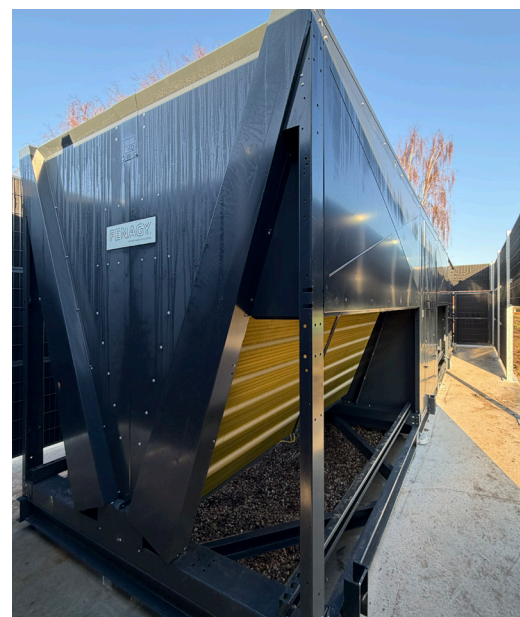
CC-varmepumpe og V-shape fordampers (energiopsummer) installeret i en støjdæmpende indkapsling.
