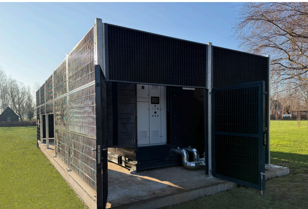
Varmpumpen er indkapslet med støjskærme.
