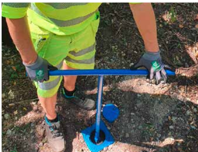
Underjordsinstallation af skydeventil med VIDI Positioner, der registrerer, når ventilen betjenes.
