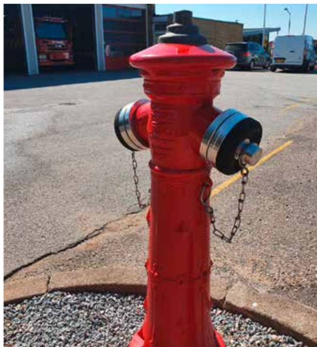
Brandhane med VIDI Cap installeret ved den lokale brandstation. Det påvirker i høj grad trykket i forsyningsnettet, når en brandhane bliver brugt. For at skelne mellem tryktab forårsaget af brug af brandhaner og tryktab forårsaget af normalt forbrug er det derfor vigtigt for forsyningen at vide, hvornår brandhanerne bliver brugt.
