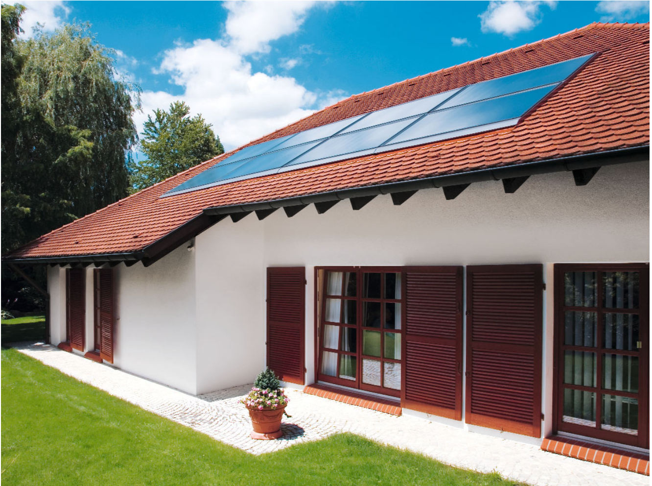
Solfangeranlæg kombineret for brugsvandsproduktion og understøtning til centralvarmen
