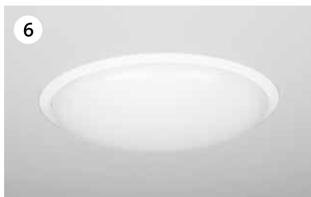
6 Så er installationen klar. Tænd armaturet.
