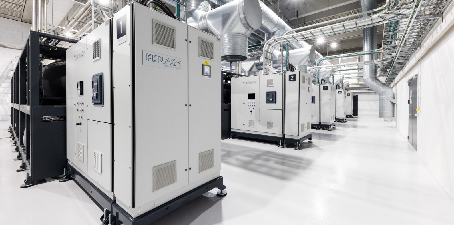
Fem H-2600 CO 2 -varmepumper i det nye maskinrum
