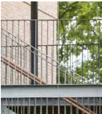
Trapper og svalegange i galvaniseret stål
