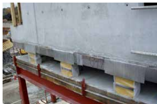
Liljeholmstorget står på GERB stålfjäderelement och avskärmar stömljud från Liljeholmens t-banestation
