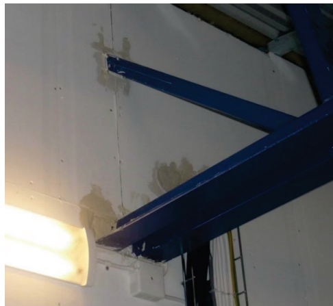
Figur 1 Avskiljande vägg som stabiliseras av oklassat bjälklag. En lösning som var ok i Sverige fram till och med EKS 9 men inte efter det (foto: J. Sandström).
