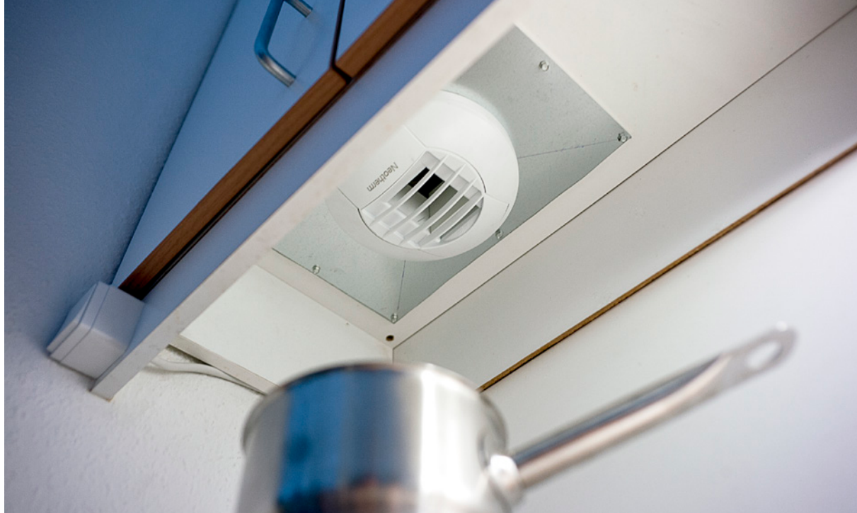
Energiforbruget nedbringes til en tredjedel med Neotherm ventiler i køkken og bad.
