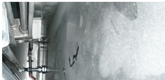
Emhætteudsugningskammer med UV-C lys efter flere ugers drift.
